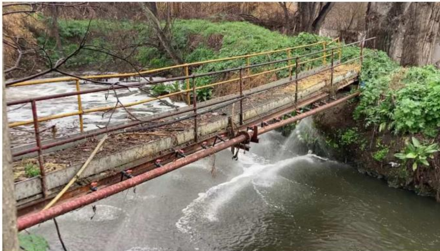
Figura 8. Detalle de la aplicación de duchas antiespumantes fuera de la EDAR de Butarque.
