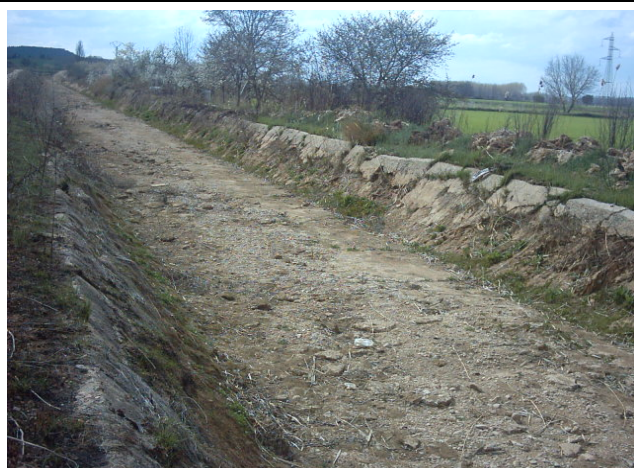
Tramo del Canal de Guma en mal estado
