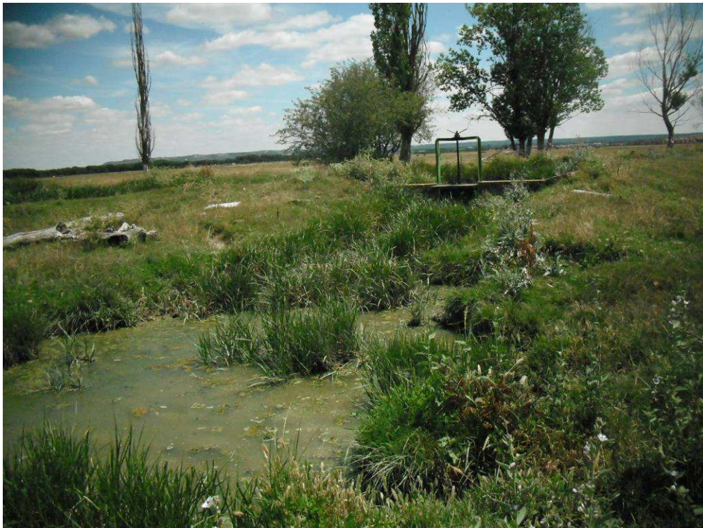
Figura 4. Las aguas retenidas por el azud se encuentran en un mal estado químico.
