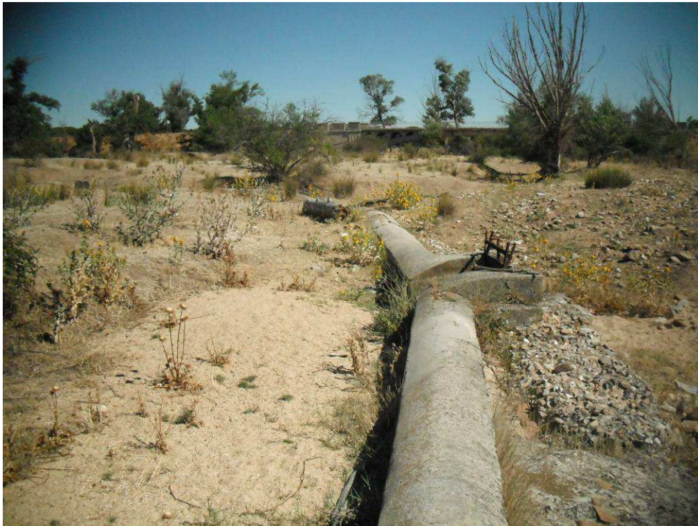
Figura 5. Tramo del río Trabanco en Castronuño, obras de protección de los márgenes, que producen un impacto añadido a los hidrológicos y morfológicos que afectan a este tramo.
