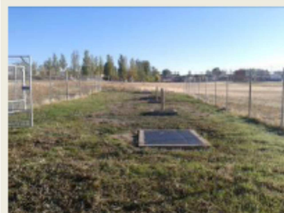
Fosa séptica. Torreiglesias (Segovia)
