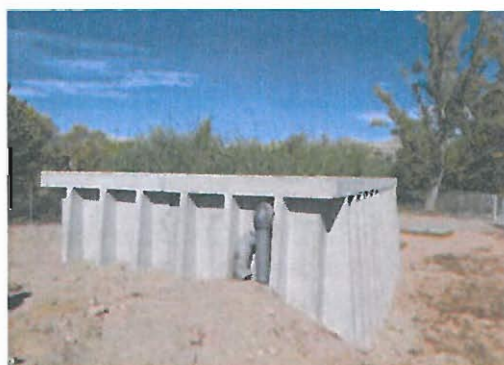
Tanque Imhoff. Tardajos (Burgos)
