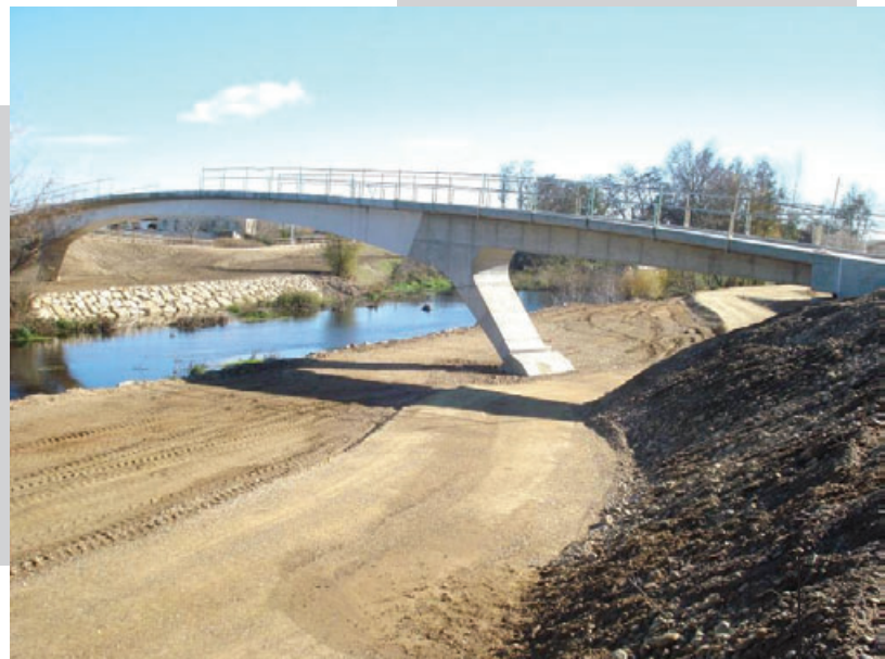
Pasarela de aguas arriba sin barandilla
