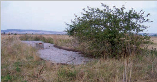
Estado de la fosa séptica en enero de 2005.
