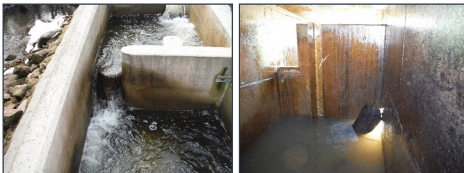
Figura 78. Obstrucciones en un vertedero (izquierda) y en un orificio de fondo (derecha) debidas a los restos arrastrados por la corriente al interior del paso.
