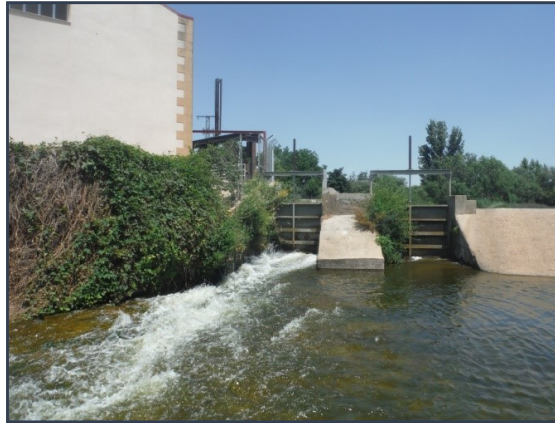
Figura 56. Compuertas para el vaciado del azud que se encuentran en la margen contraria a la escala, junto a la central hidroeléctrica.
