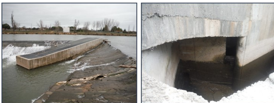
Figura 84. Ejemplos de pasos piscícolas que se encuentran parcialmente oscurecidos por elementos instalados sobre ellas o una altura excesiva de los cajeros.
