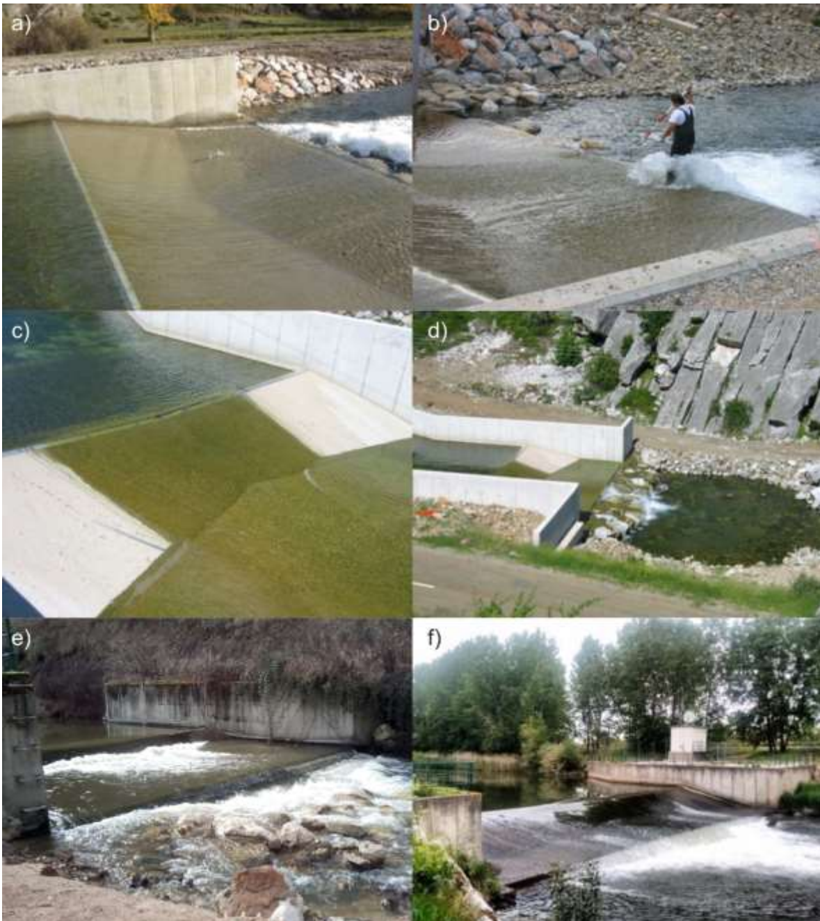
Figura 4. Diferentes ejemplos de la problemática existente. Descalce de la estructura (a, b, d, e y f). Escasa profundidad en el paramento (c y f). Alta velocidad del flujo en el paramento (b y f). Turbulencia excesiva (e).
