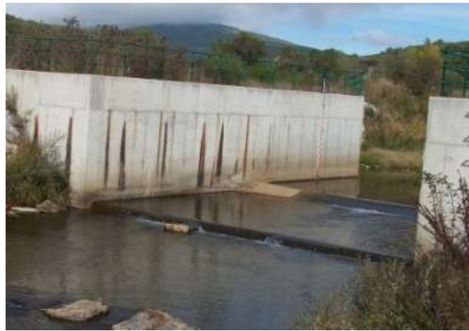
Figura 12. Ejemplo de una estación de aforo V-Flat en San Salvador de Cantamuda (Palencia) y su estado actual con una prepresa previa. Este tipo de actuaciones puede aumentar el salto después de la losa.
