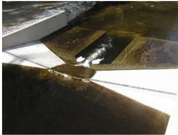
Figura 14. Ejemplo de una poza realizada en la losa horizontal de aguas abajo de una estación de aforo en Beguntillo (Lugo).
