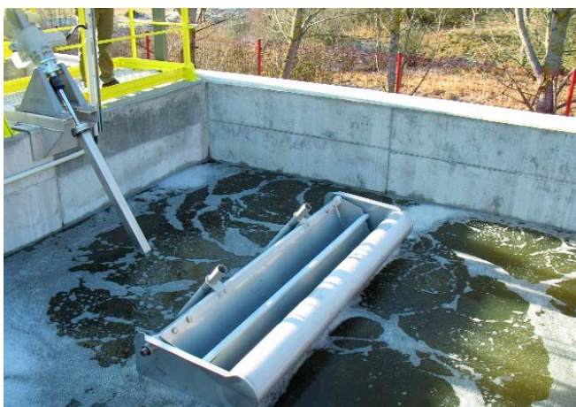
Interior de las depuradoras del Alto Duero (Soria).
