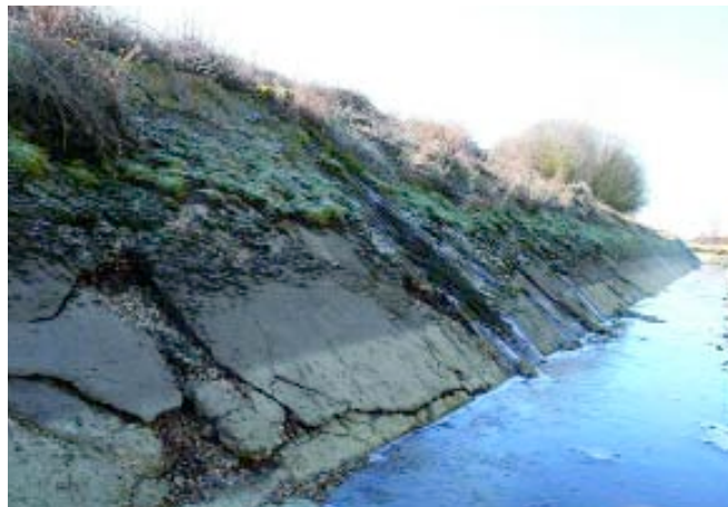
Roturas severas en los paños de la margen izquierda del Canal del Órbigo (León).
