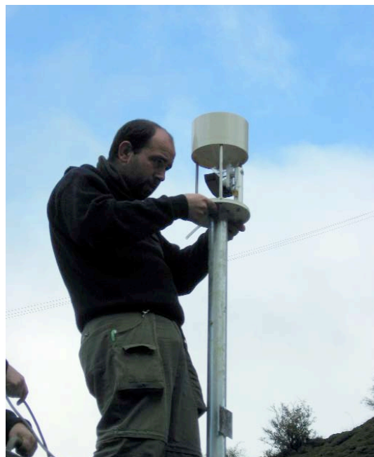
Operario instalando un Pluviómetro.
