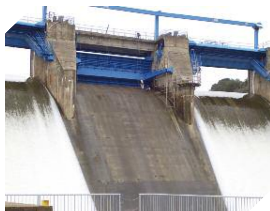
Foto 7.28. Obras de modernización de los órganos de desagüe de la presa del Águeda (Salamanca)
