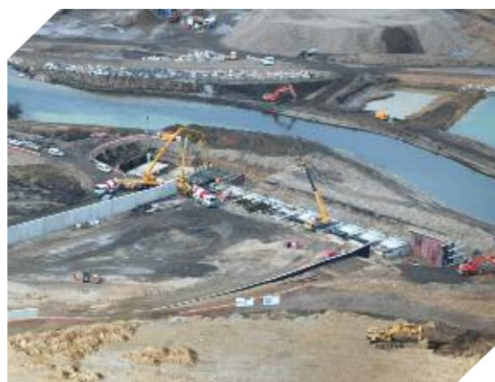
Foto 7.14. Vista aérea de la construcción del azud de toma en el río Esla del Canal Bajo de los Payuelos en Sahechores (León)
