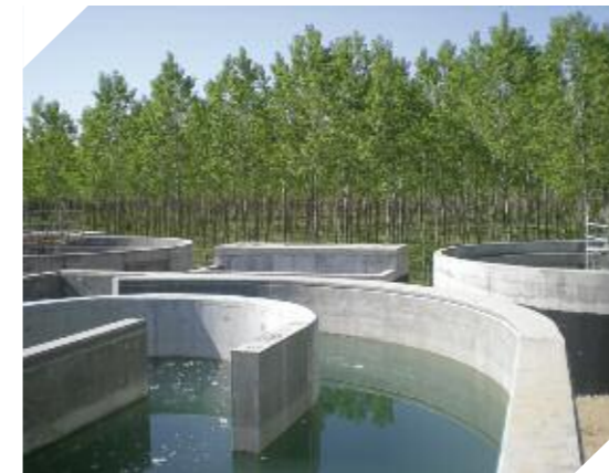
Foto 7.24. Depuradora del Alto Órbigo (León)
