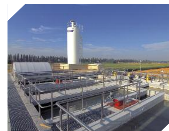
Foto 7.18. Estación depuradora en Tudela de Duero (Valladolid)
