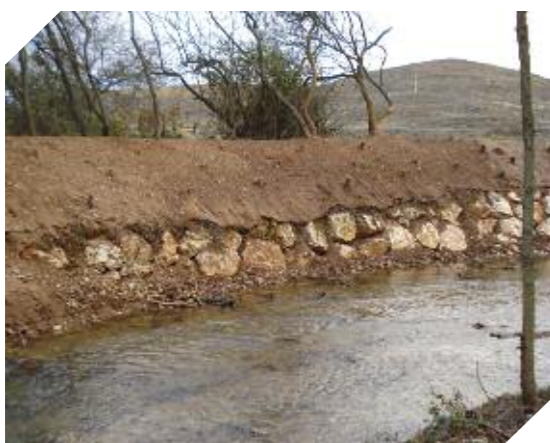
Foto 6.11. Actuación de protección de márgenes frente a la erosión en el río Ausines en Los Ausines (Burgos)
