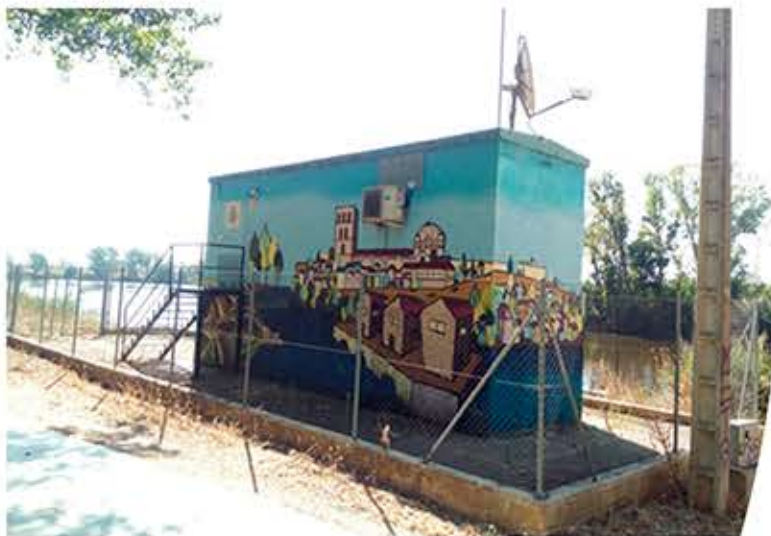
Estación-Punto de control SAIH Duero
