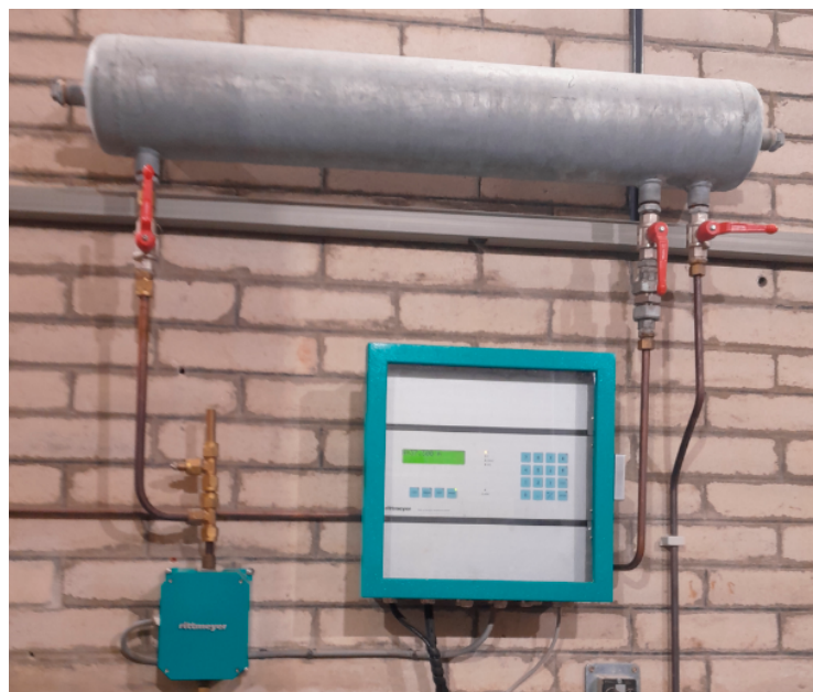
Figura 5. Medida del nivel de la presa por presión, calderín de compensación y sonda por reloj de cuarzo.
