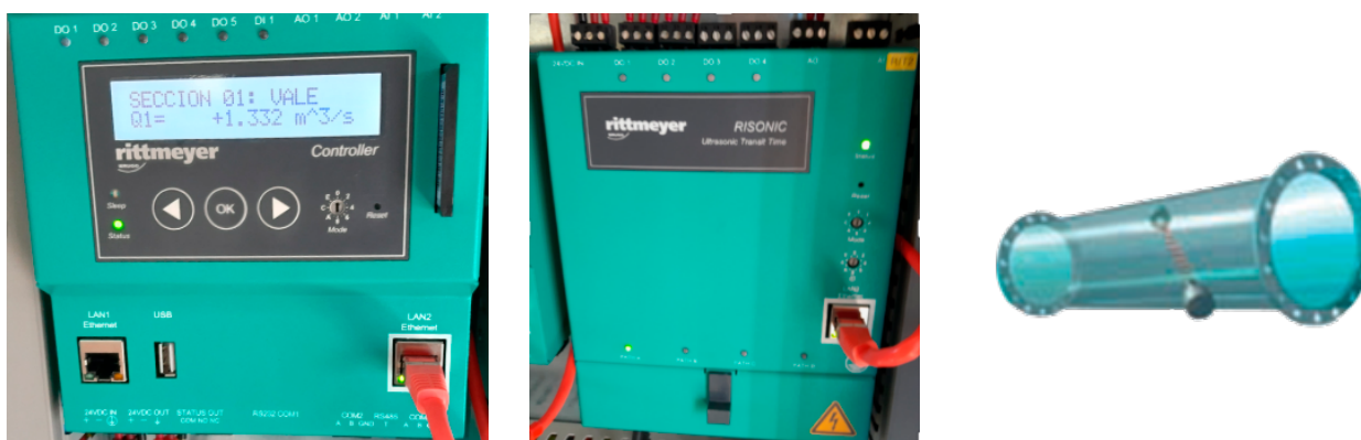
Figura 9. Caudalímetro. Unidad central, generador de ultrasonidos y posición de los sensores en tubería.
