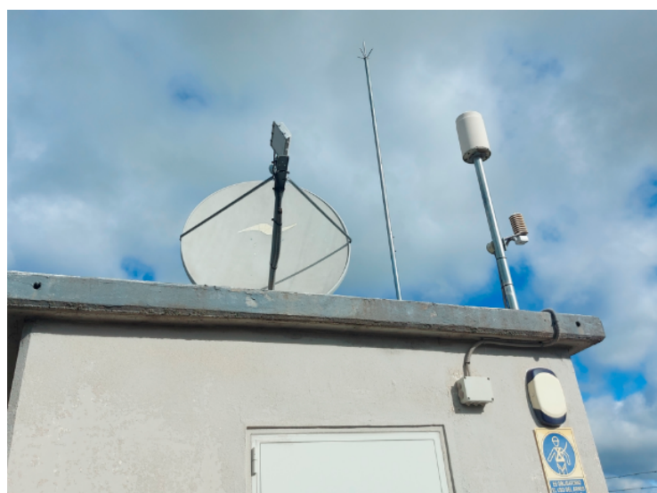
Figura 6. Parte superior de la típica "caseta SAIH" con antena para satélite, pluviómetro, termómetro y pararrayos.
