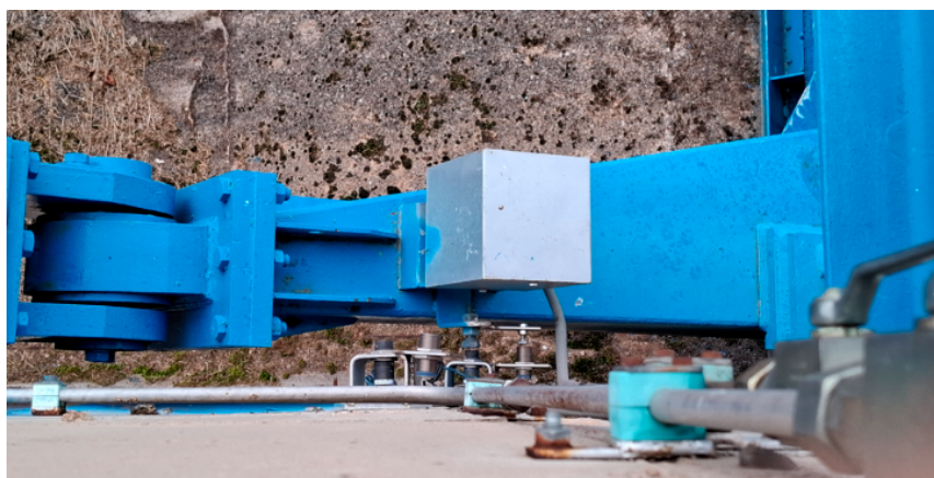
Figura 8. Brazo de compuerta con sensor angular instalado.
