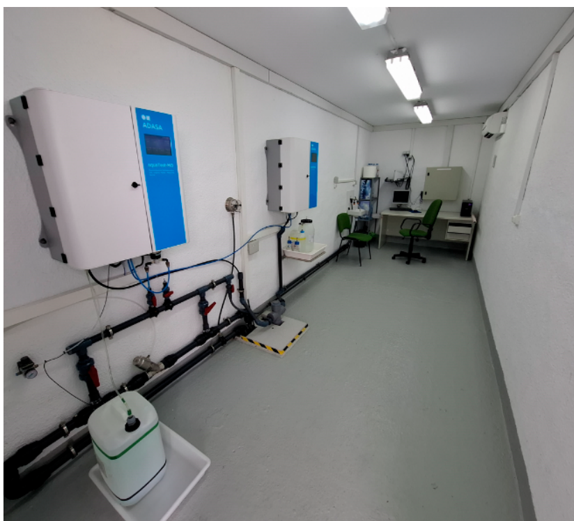
Figura 35. Interior de una Estación Automática de Alerta de la red SAICA.
