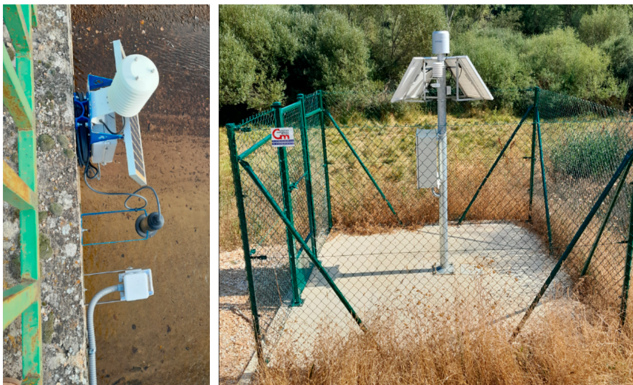
Figura 12. Ejemplos de instalación compacta: radar y termómetro sobre el río, pluviómetro, termómetro y equipamiento electrónico en poste dentro de recinto vallado.
