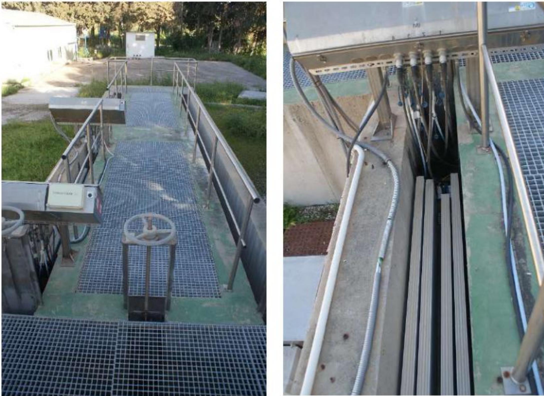
Figura 27. Fotografías de la EDAR de Manila. De arriba abajo y de izquierda a derecha: vista del reactor biológico en primer término; decantador secundario; cámaras de coagulación y floculación; microtamiz abierto para mostrar su interior; canal del sistema UV y una bancada de lámparas UV con cuatro módulos. (Fuente: autor)
