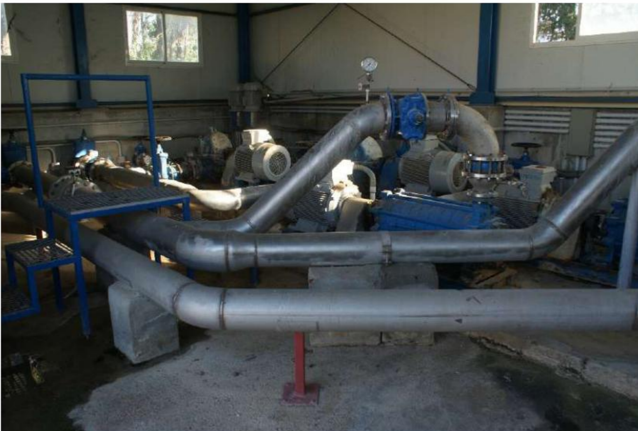
Figura 28. Fotografía del sistema de bombeo. (Fuente: autor)
