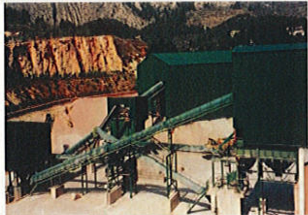
Ilustración 68: Carenado de las instalaciones
