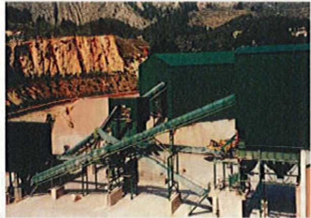
Ilustración 68: Carenado de las instalaciones
