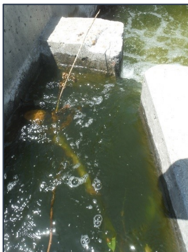
Figura 60. Obstrucción parcial detectada en la hendidura que conecta los estanques 3 y 4.
