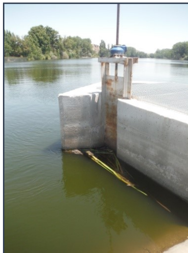
Figura 58. Compuerta y deflector en la salida de peces, es decir, en la alimentación de la escala.
