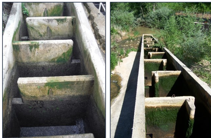
Figura 82. Estanques sin deflectores (izquierda) y con ellos (derecha).
