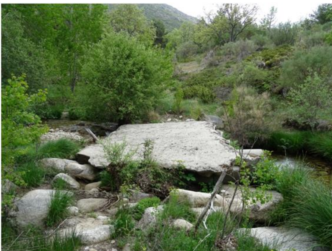
Paso entubado derruido del Puente de la Ramona.
