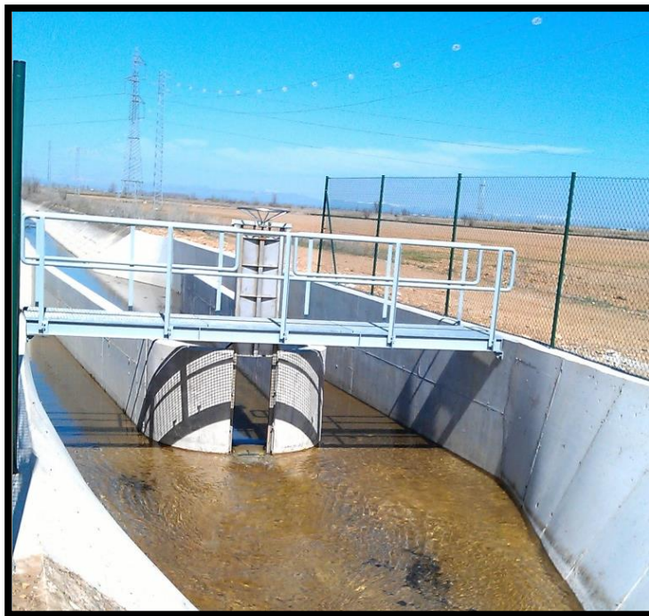
Toma del Canal de Matalobos, Canal del Páramo (León). Autor: José Reguera Acevedo.
