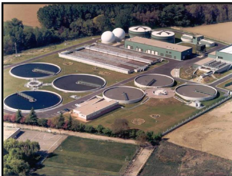
EDAR de la ciudad de Palencia. Autor: Área de Calidad de las Aguas de la CHD.
