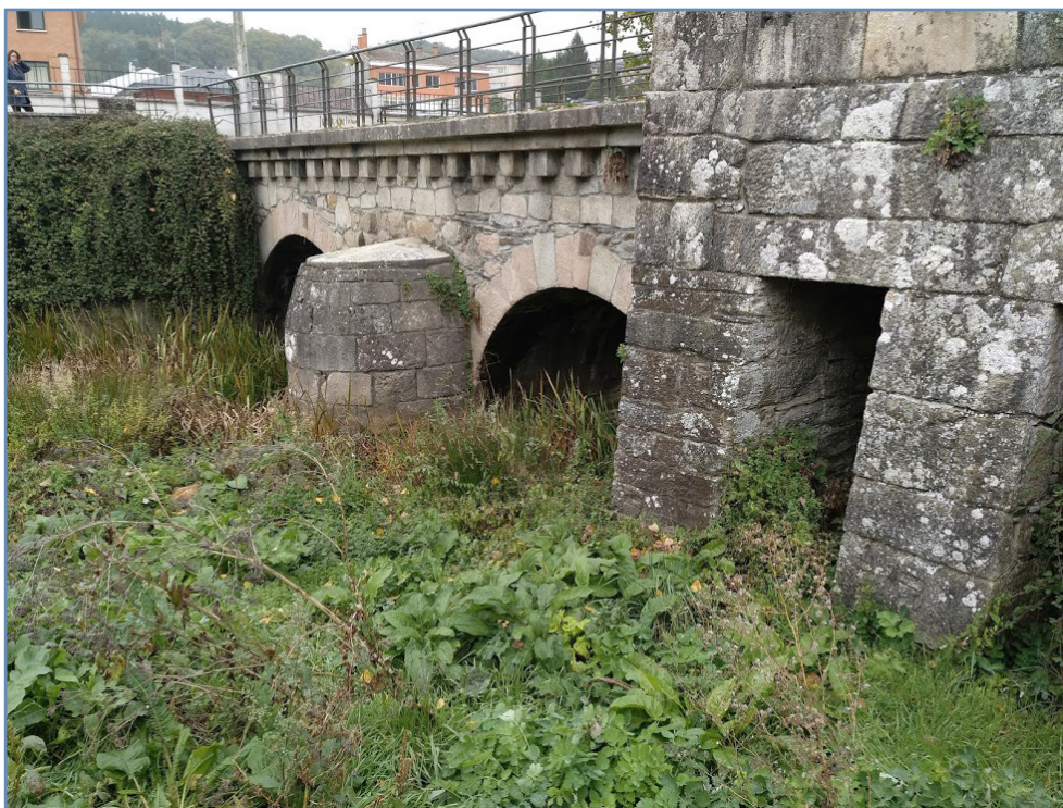
Foto 4. En muchas ocasiones, los puentes y otras estructuras transversales a los cauces son importantes obstáculos a la hora de la circulación del caudal en episodios de crecidas. El mantenimiento y conservación del cauce en el entorno de la obra es responsabilidad del titular de la misma. Puente sobre el Río Pequeno en Sarria (Ourense, cuenca del Miño Sil).
