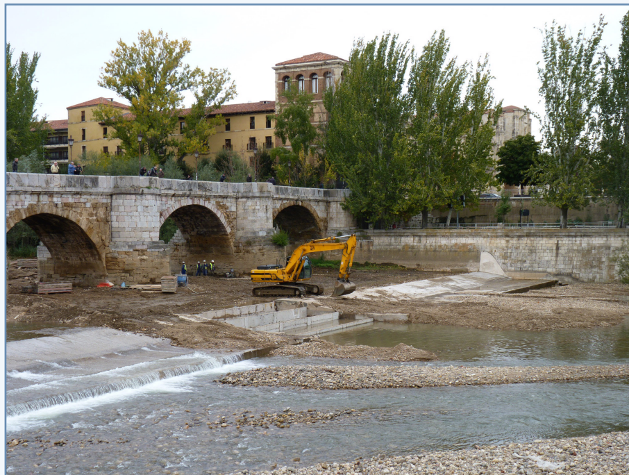
Foto 24. Imagen del proceso de la demolición parcial del azud del puente de San Marcos en el río Bernesga en León.
