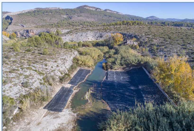
Foto 18. Colocación de láminas de geotextil para la lucha contra el rebrote del rizoma de la caña.
