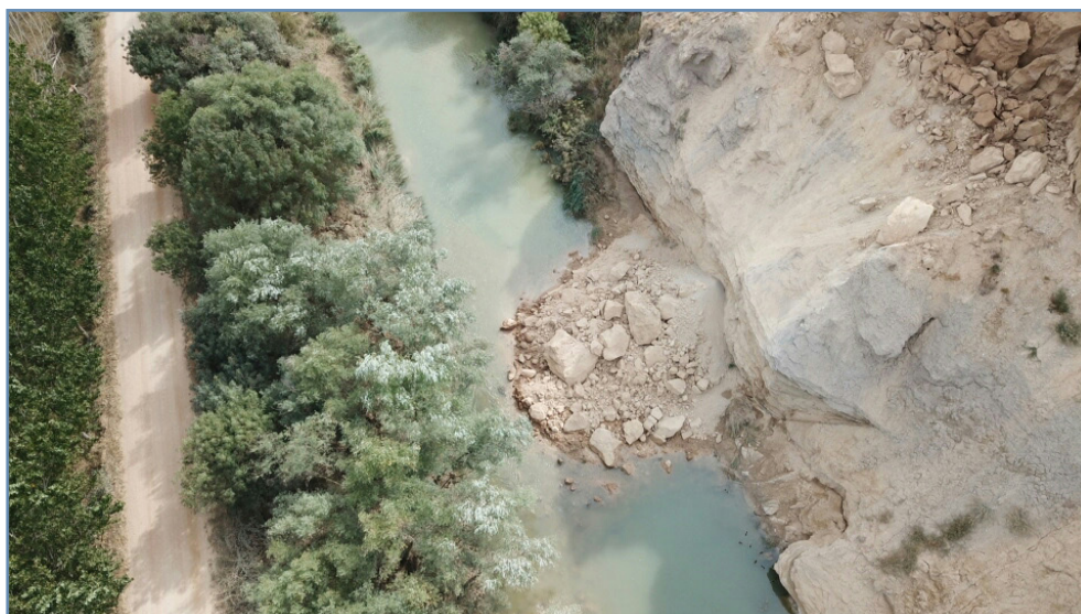
Foto 7. Deslizamiento de ladera sobre el río Ega en Carcar (Navarra) que disminuye la capacidad de desagüe del mismo.
