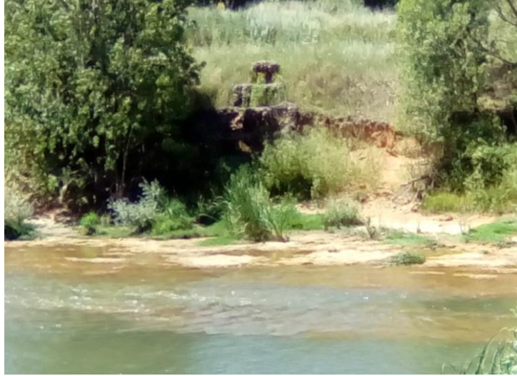
Figura 24. Vista desde la margen izquierda de un espigón de gaviones colgado. La fotografía pertenece a la coordenada longitudinal s = 9.4 km. Fecha: 24 de julio de 2018.
