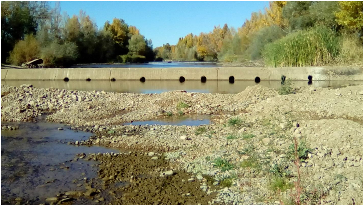
Figura 16. Vista hacia aguas arriba de la traviesa 28, que se acabó demoliendo durante el otoño de 2018, después de la foto. El material aluvial es visible por las obras demolición de la traviesa 29, situada unos 160 m aguas abajo de la que se observa en la fotografía (Figura 17). Esta imagen pertenece a un punto situado en la coordenada longitudinal s = 12.0 km.
