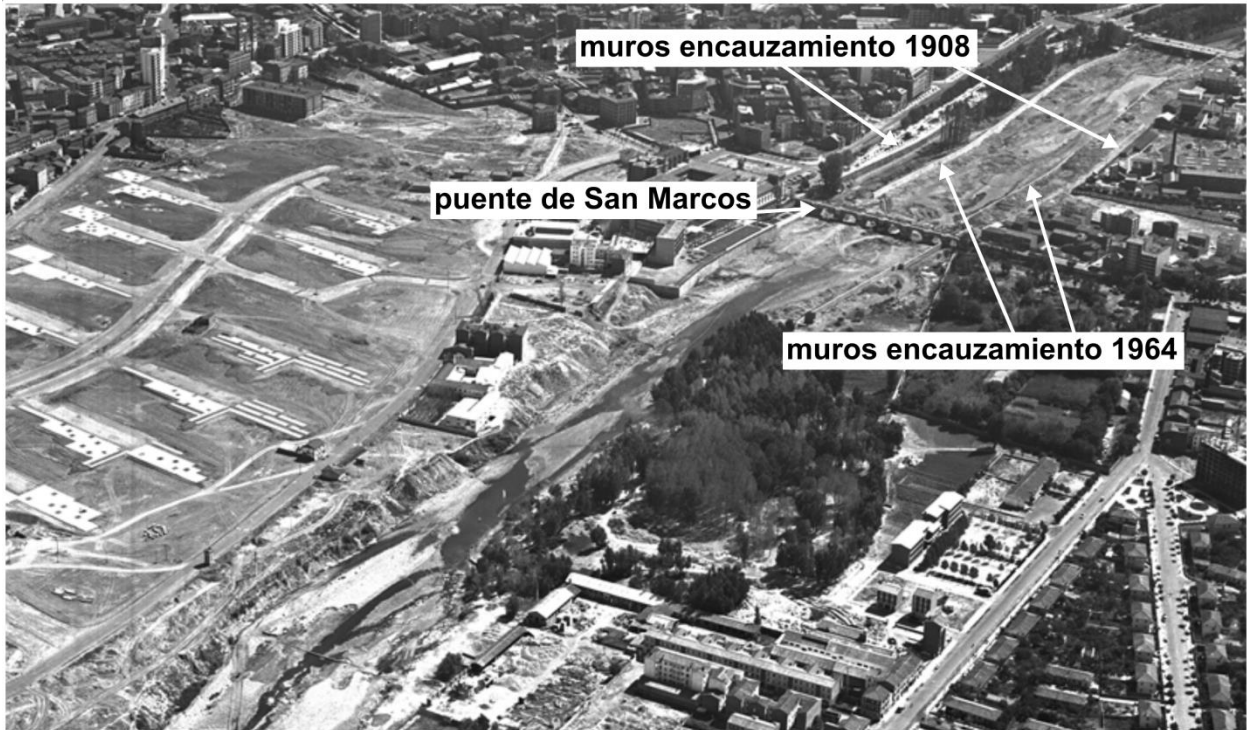
Figura 46. Obras de la nueva canalización entre los puentes de San Marcos y de los Leones. El agua circula de abajo a la derecha hacia arriba a la izquierda. Fotografía tomada en agosto de 1966. Comparar con Figura 31. Fuente: Ejército del Aire.
