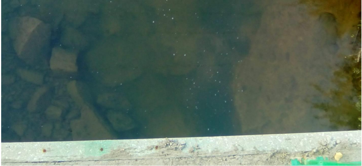
Figura 15. Vista del zócalo arcilloso del fondo del cauce desde la pasarela 10 (Tabla 2).
