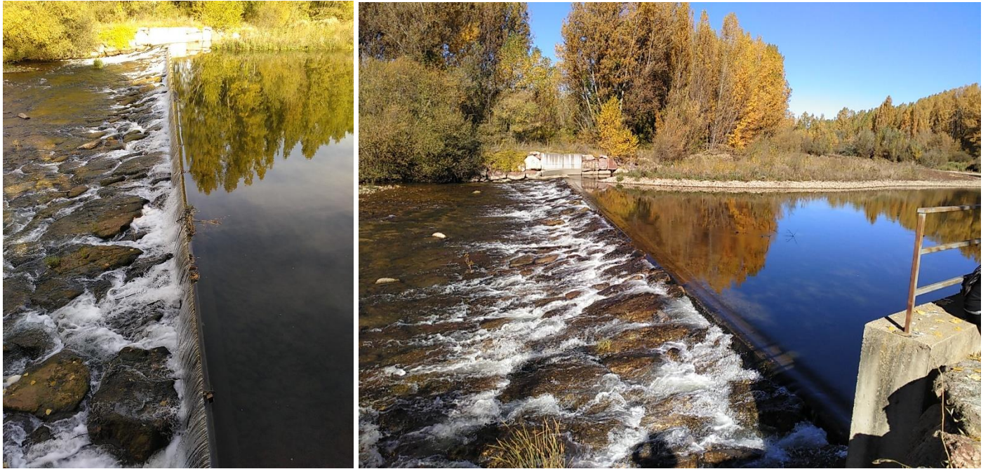
Figura 68. Azud Sariegos, pequeña obra civil con un suplemento móvil (desmontable). Fotos 1-X-2018 a la izquierda (con suplemento) y 25-X-2018 a la derecha sin él.
