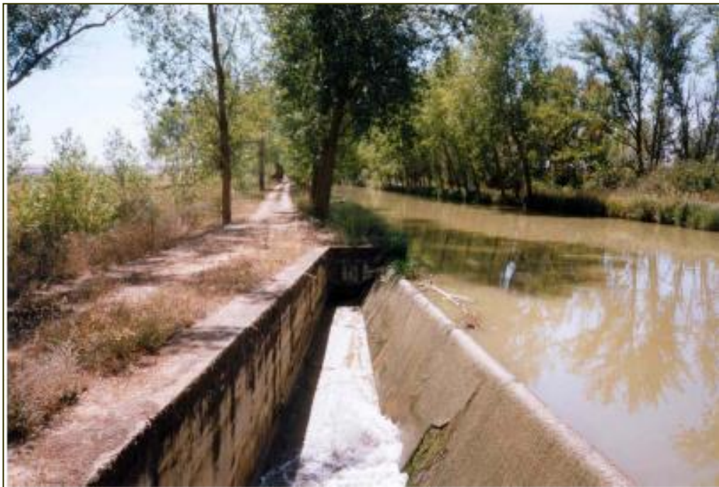
Figura 9. Derrame de Pozo Pedro (Valladolid).
