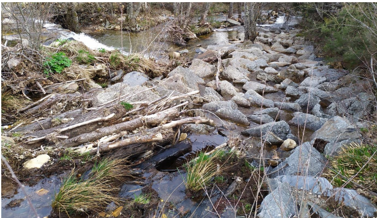
FIGURA 38. ENTRADA DE RAMPA PARCIAL DE BLOQUES OBSTRUIDA QUE IMPOSIBILITA EL FUNCIONAMIENTO DEL PASO, RÍO NEGRO (DONEY DE LA REQUEJADA, ZAMORA).
